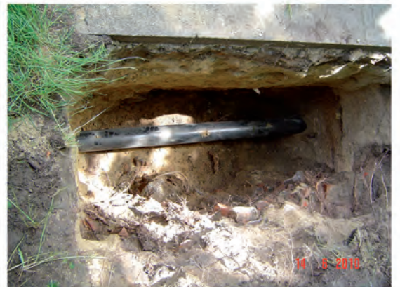
Rohrtrasse nach fachmännischer Entfernung der Wurzeln
